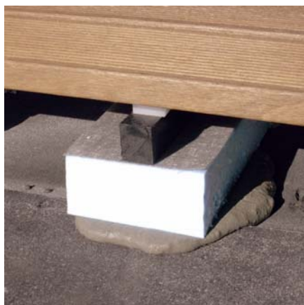
b. geo-włóknina / pasy styroduru na zaprawie spadek 0 – 2,5 % / papa na różnych spadkach lub nierówna lub układana zakładkowo / **
