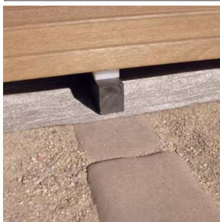
h. kostka brukowa (krawężniki, itp.) pod legarami montażowymi deck-u, spadek 0 – 2,5 % / ziemia / zalecana geo-włóknina → detal nr 05
